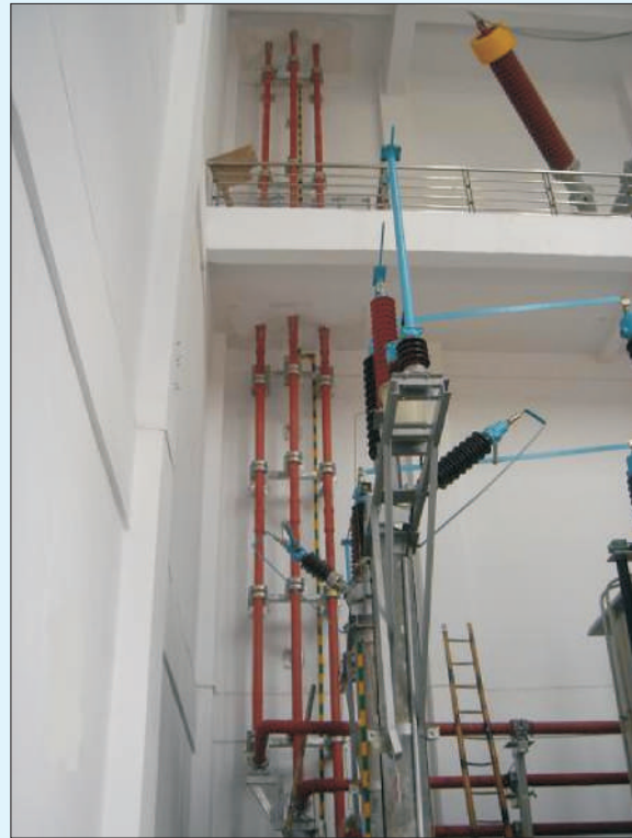
屏蔽绝缘管母线安装在高层建筑内
