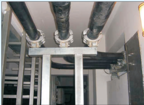
屏蔽绝缘管母线安装在电缆夹层内
