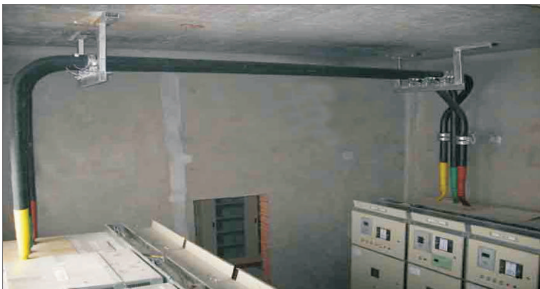
开关柜屏蔽绝缘管母线连接(开关柜母连)
